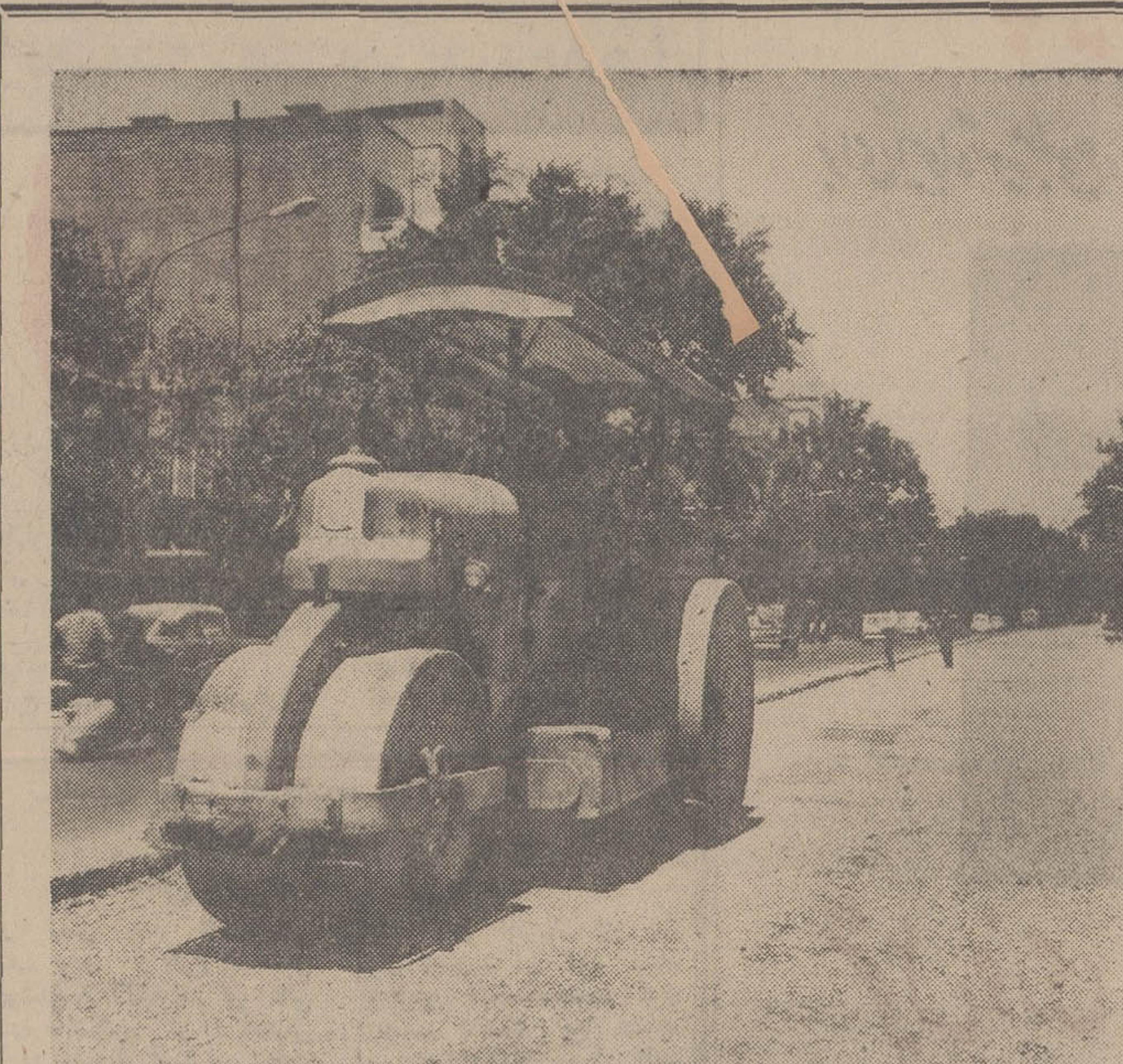
اسفالت اساسی خیابان قدیم شمیران از سه راه عباس آباد بطرف شمال آغاز گردیده و بعلافت مشکلات فراوان بعد از گذشت پنج هفته هنوز اسفالت مسافت سه کیلومتری این جاده پایان نیافته است این عکس دیروز از عملیات اسفالت کاری گرفته شده
