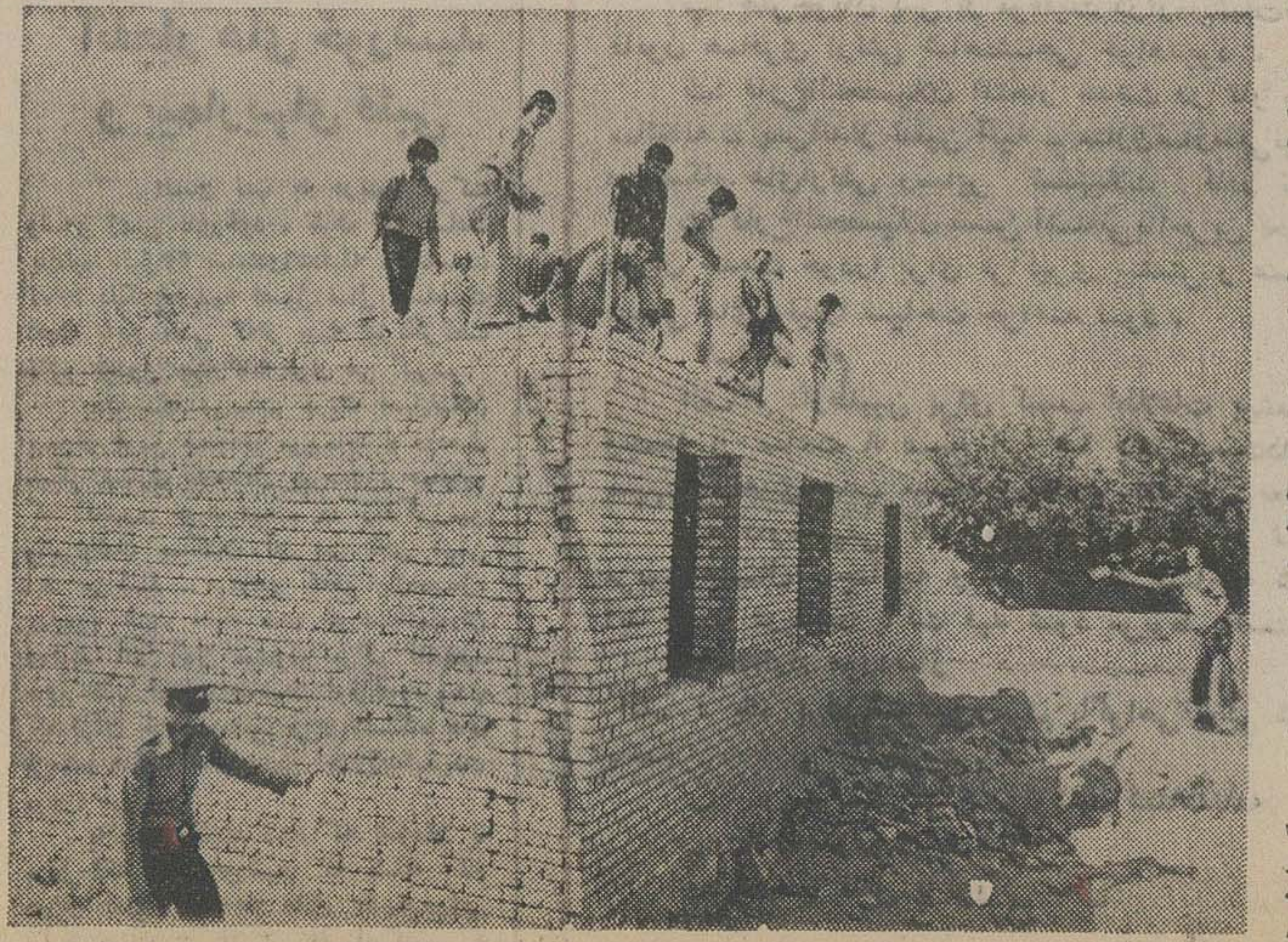
آحادات دبستان سه اتاقه در قریه جهان‌آباد توسط دانشجویان شرکت کننده در اردوهای عمران ملی.
