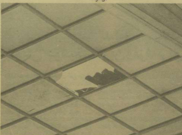
این صفحه نااستوار و کم‌ضخامت در ارتفاع ۳۵ متری بناگهان در زیر پای نصیری فرو ریخت و فاجعه... آغاز شد.
