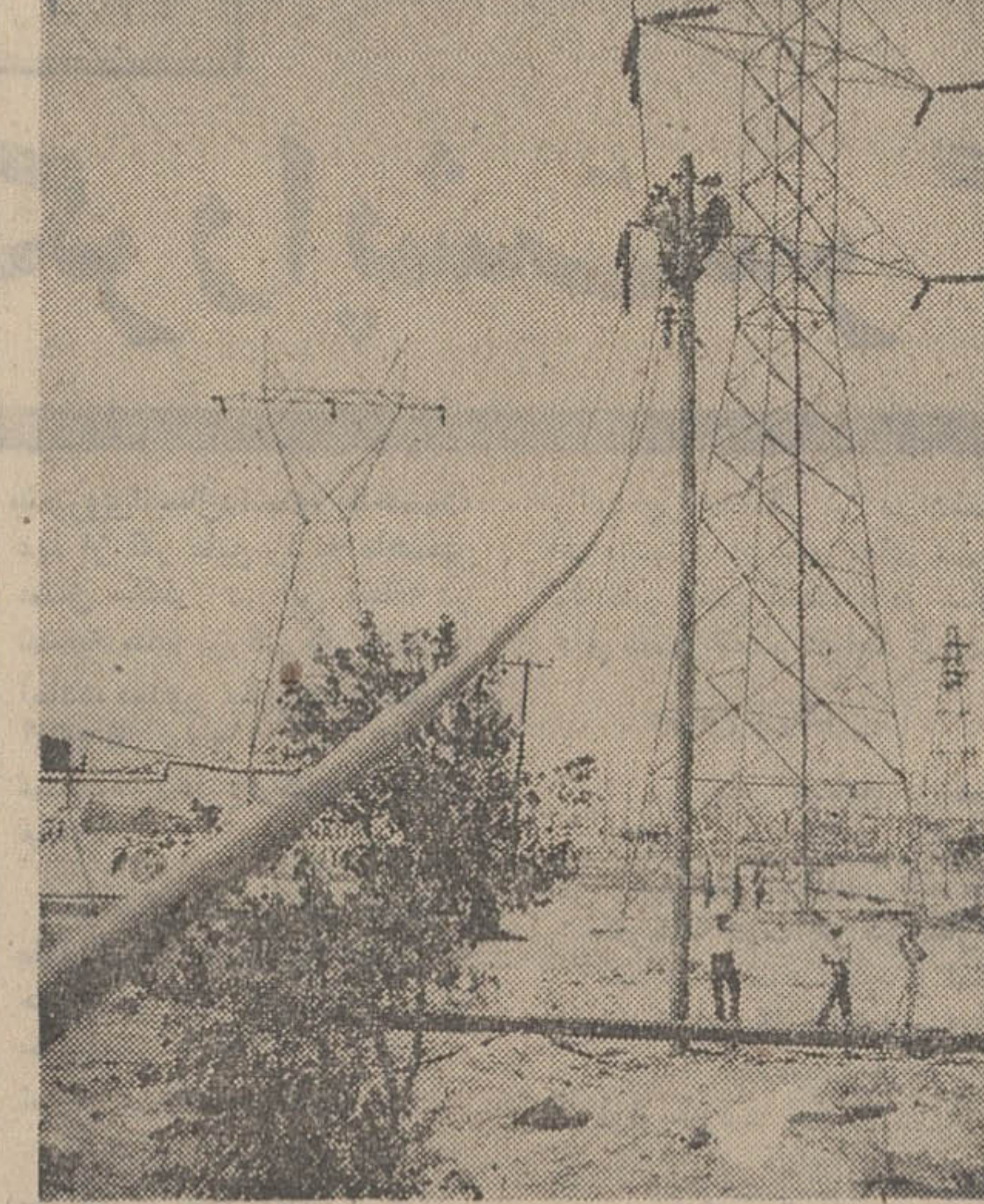
فعالیت کارگران گروه ساختمانی اداره توزیع برق ناحیه مرکز جنب ایستگاه نساجی شوش
