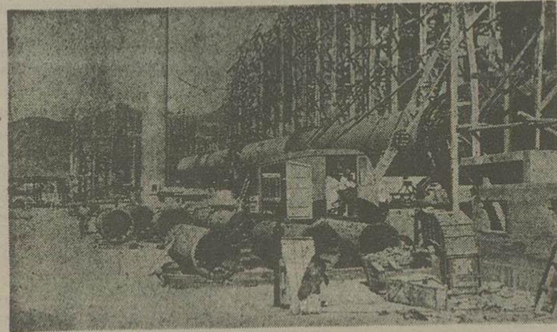
قسمتی از کوره سیمان پزی که طول آن بالغ بر ۸۰ متر است که در ظرف دو سال گذشته نصب و آماده کار شده است
