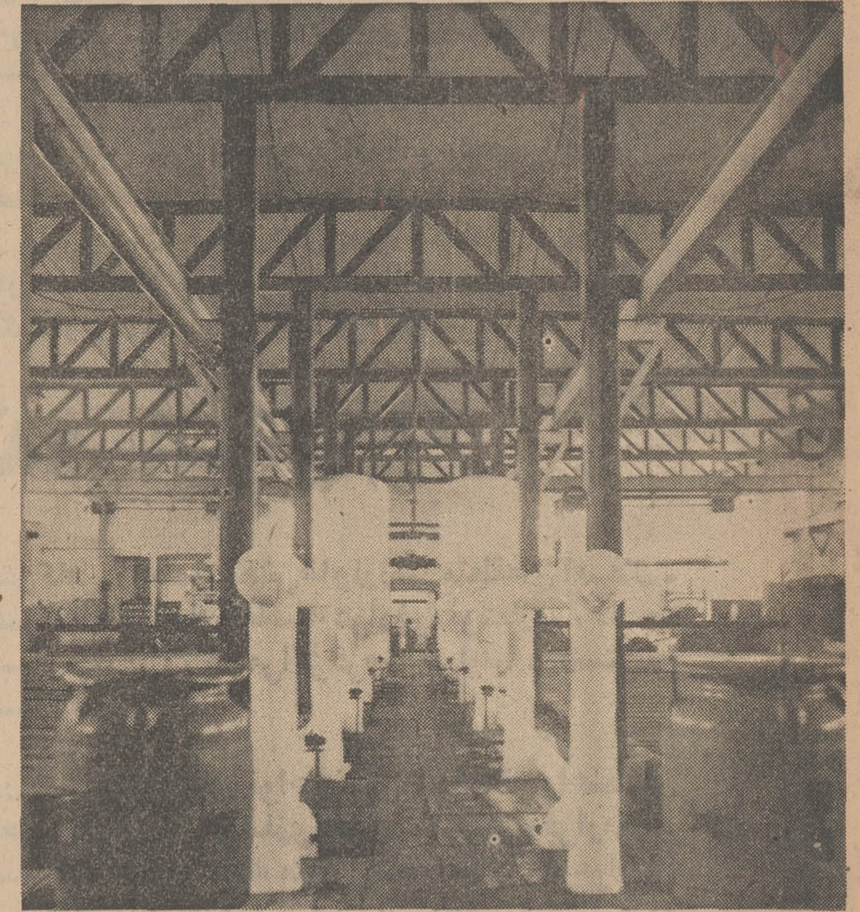
واحد دیگری از تأسیسات و تجهیزات کارخانجات عظیم یخسازی تهران که از لحاظ اهمیت در خاورمیانه بی نظیر است این واحد در جنوب تهران نصب شده است .
