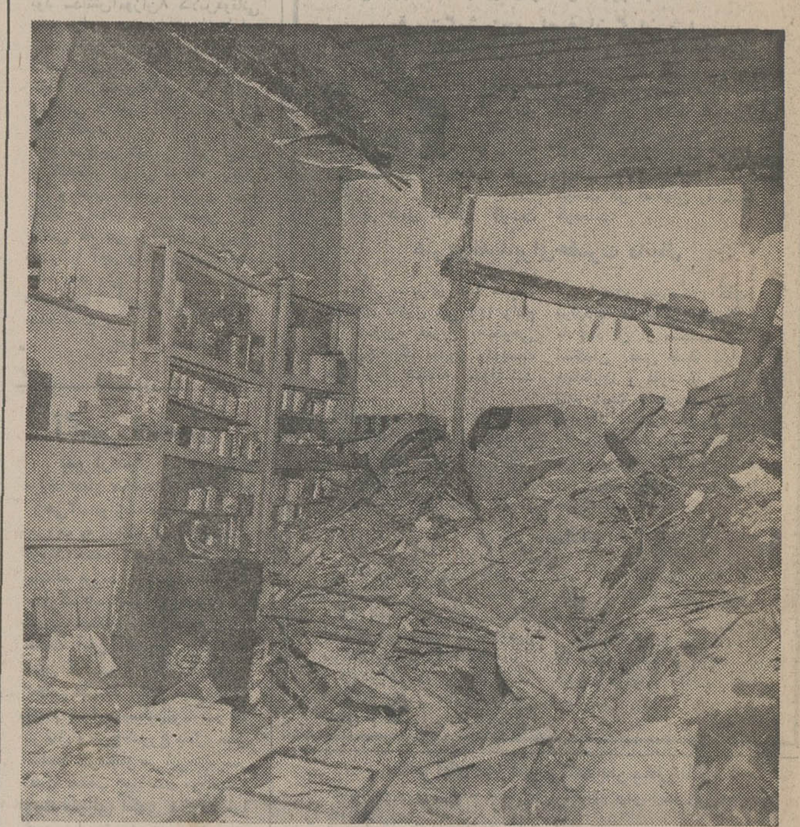
دیروز بر اثر ریزش سقف یک مغازه خواربار فروشی در چهار راه باستان (حوالی خیابان شاه) یک نفر کشته و یک نفر مجروح شد. حادثه هنگامی رخ داد که
